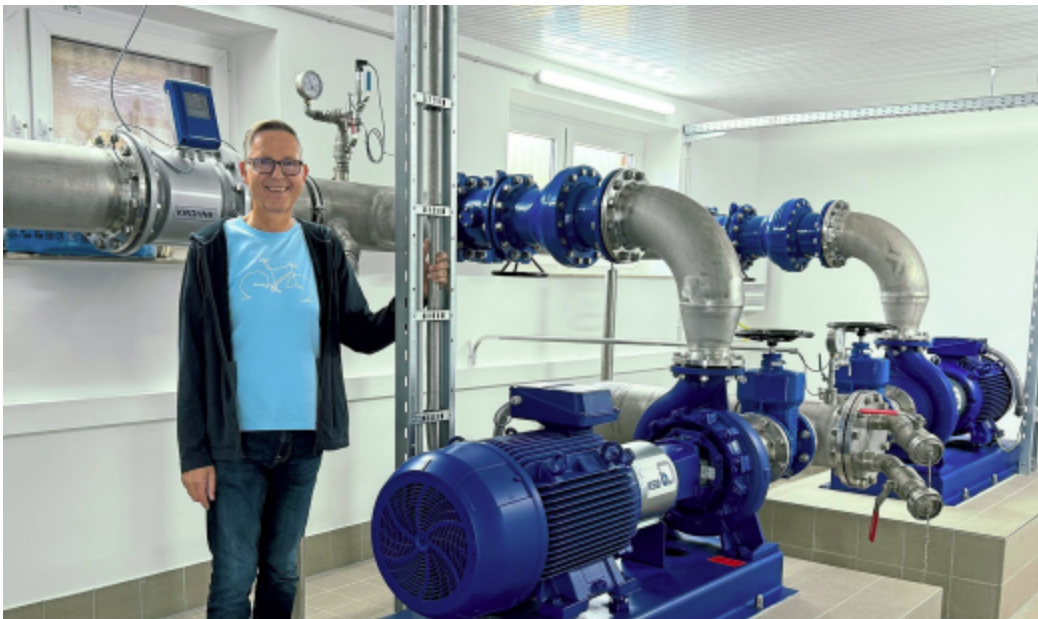
Rohrnetzmeister Stefan Goldammer präsentiert die neue Druckerhöhungsanlage.
