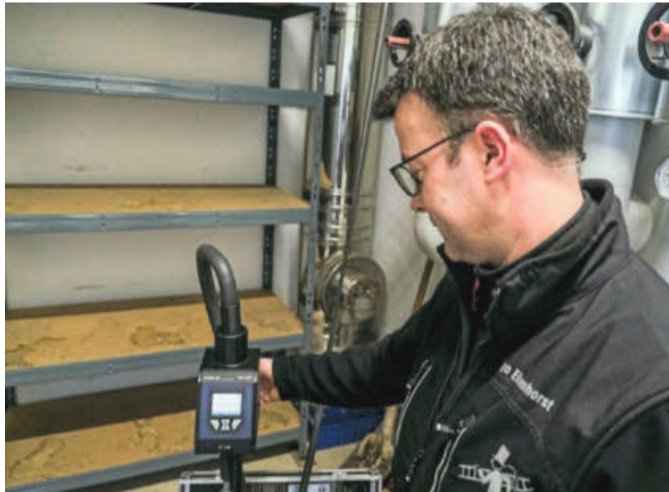
Bezirksschornsteinfeger Ingo Eikenhorst überprüft hier die Abgaswerte einer Holzhackschnittelheizanlage. Er ist zuständig für den Kehrbezirk Enger II, zu dem auch Teile von Spenge gehören. Foto: Kathrin Weege
