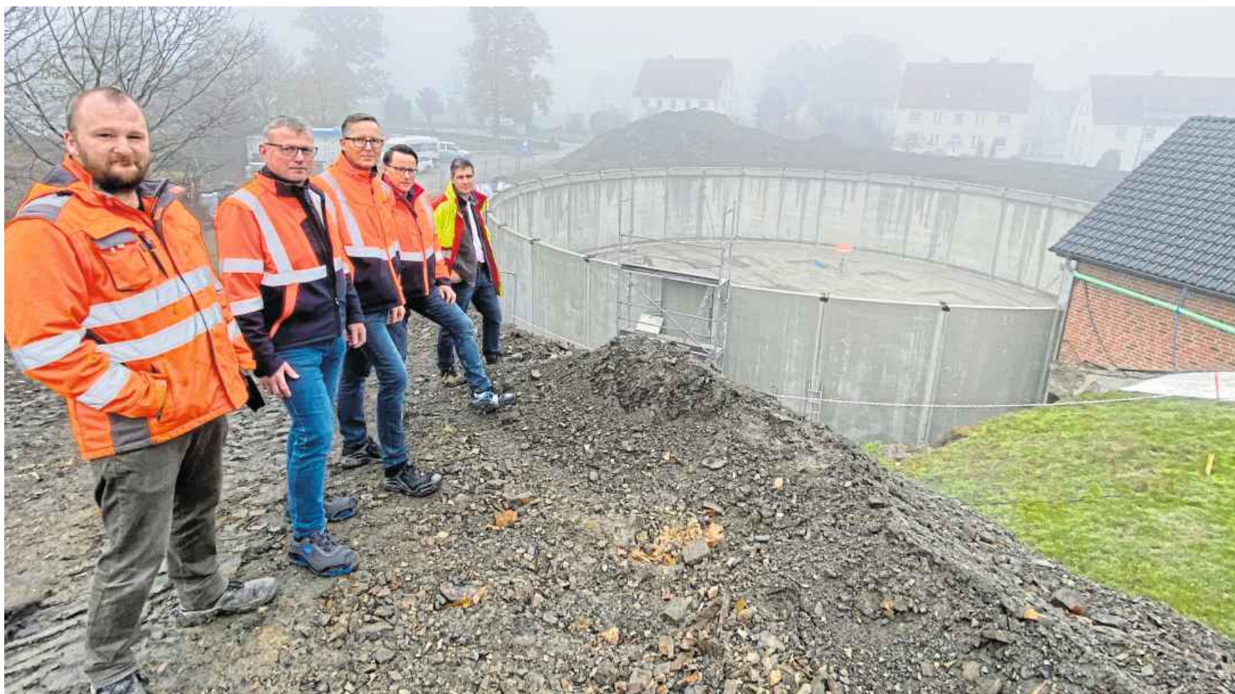
Siegfried Damsen (Firma Dressler, v.l.), Holger Freymuth, Stefan Goldammer, Thorsten Held (alle Stadtwerke) und Stefan Ludewig (Ingenieurbüro Ludewig) stehen neben dem neuen Hochbehälter. Foto: Dirk Windmüller
